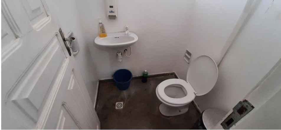
Imagem 08 – Banheiros dos consultórios.
