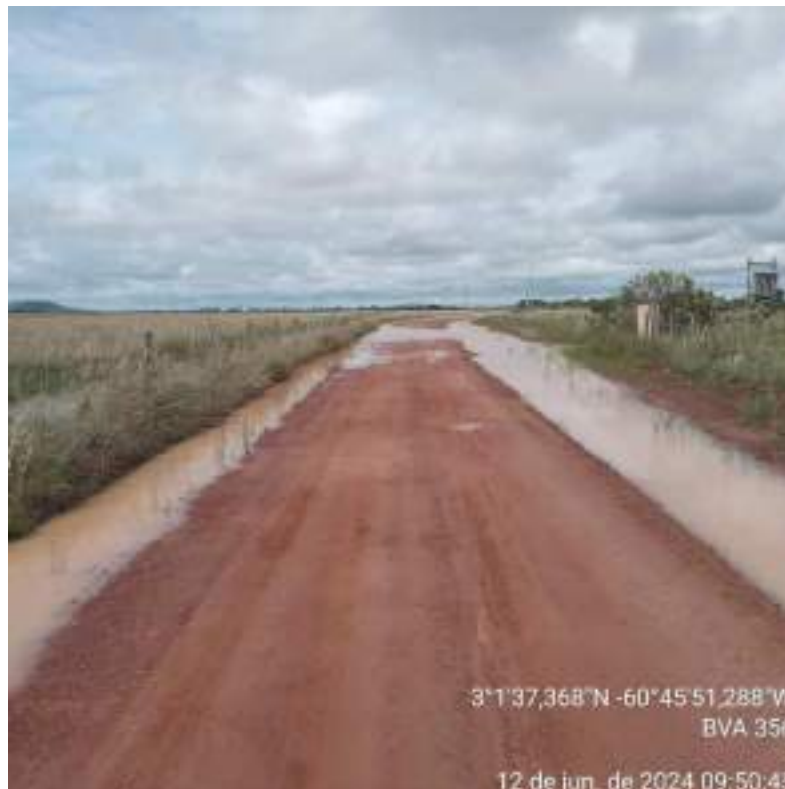
IMAGEM 06 – BVA 356 ACUMULO D'ÁGUA KM 1,2
