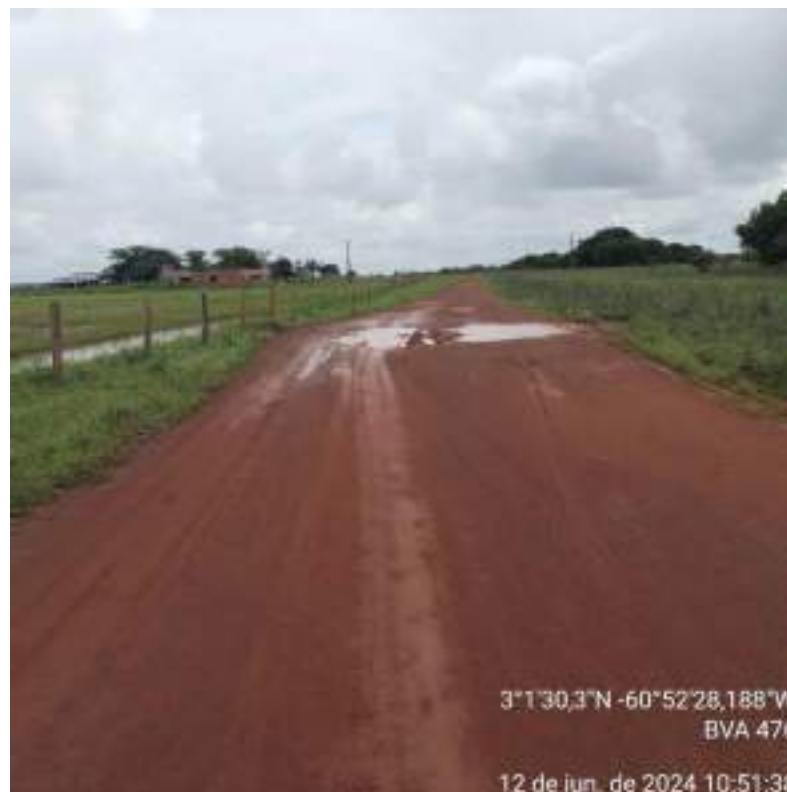
IMAGEM 10 – BVA 476 ACUMULO D'ÁGUA KM 4,3
