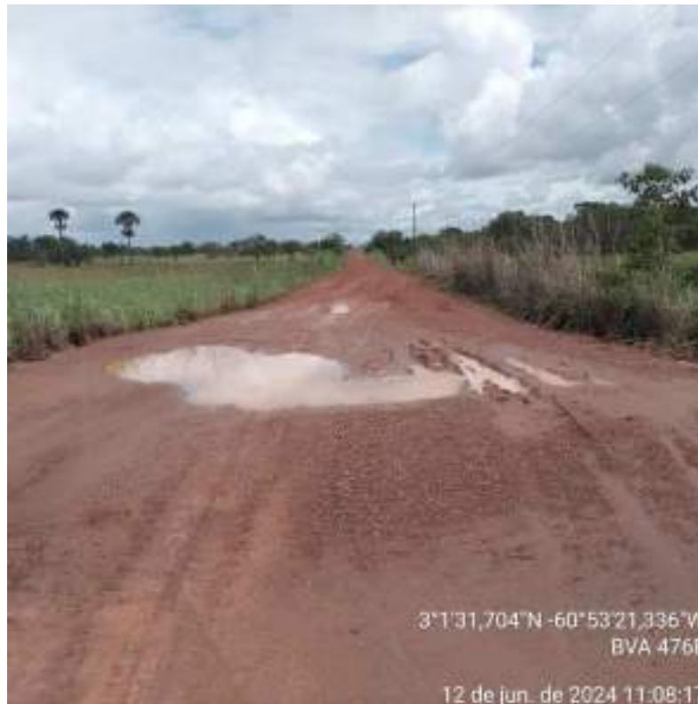
IMAGEM 06 – BVA 476B ÁCUMULO D'ÁGUA KM 02
