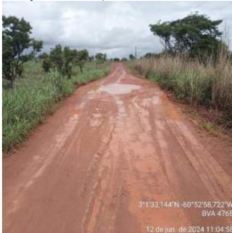
IMAGEM 03 – BVA 476B ÁCUMULO D'ÁGUA KM 0,7
