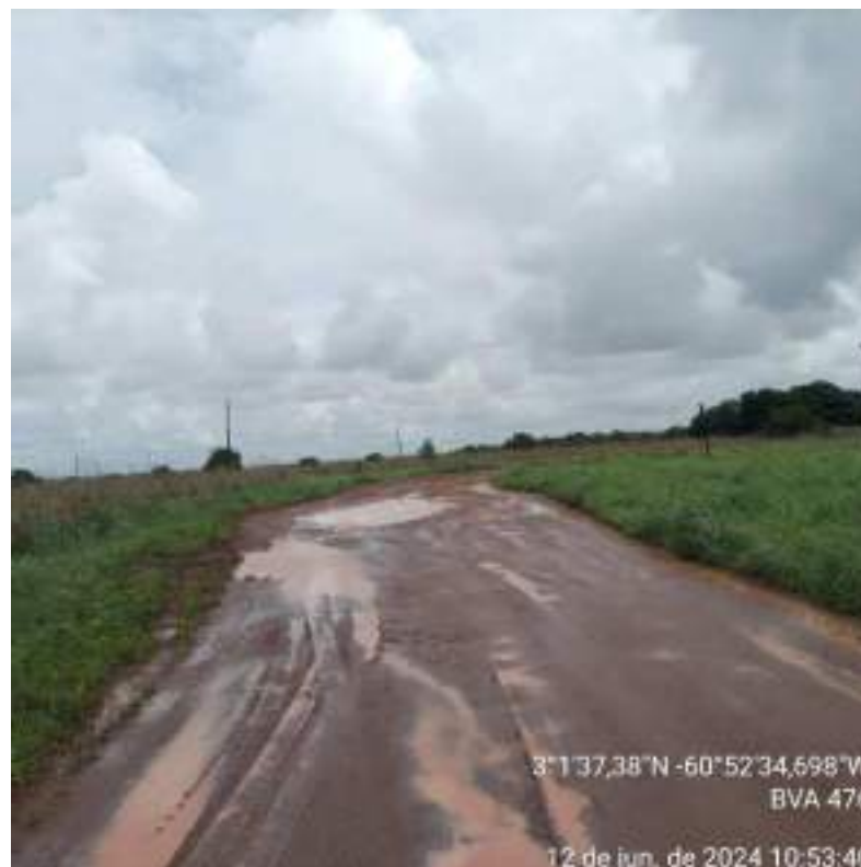
IMAGEM 12 – BVA 476 ACUMULO D" ÁGUA KM 4,7
