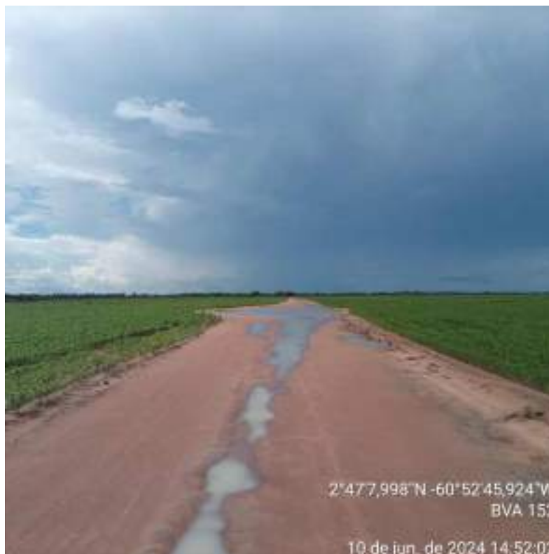
IMAGEM 08 – BVA 152 KM 05 ACUMULO D'ÁGUA
