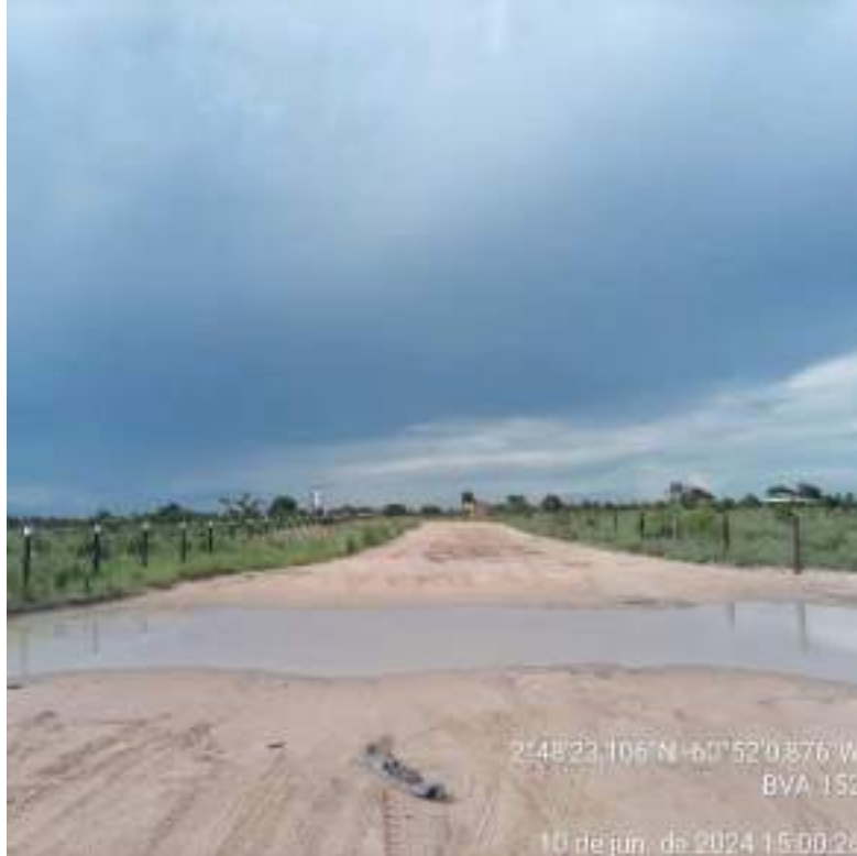
IMAGEM 11 – BVA 152 KM 08 ACUMULO D'ÁGUA
