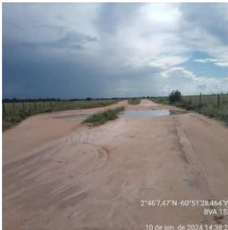
IMAGEM 04 – BVA 152 TRECHO COM ACUMULO D'ÁGUA PROXIMO KM 01
