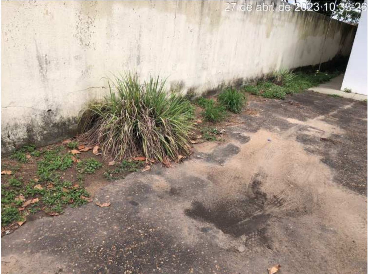
Imagem 04 – Área necessita de limpeza.
